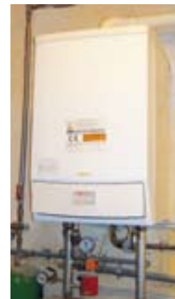
Caldaia palazzo comunale
